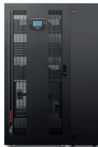
Multi Sentry MST 160-200 avec entrée des câbles par le haut.
